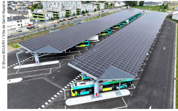
Ombrières solaires au nouveau centre d'exploitation des bus électriques.
